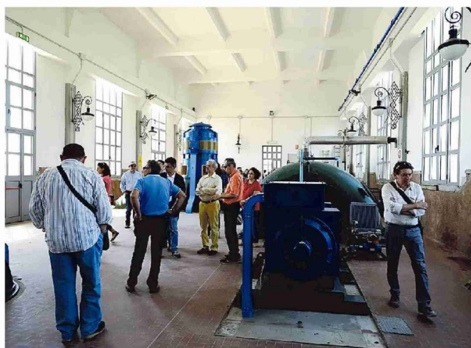
L'interno dell'idrovora Fiorana del Consorzio Bonifica pianura Ferrara
